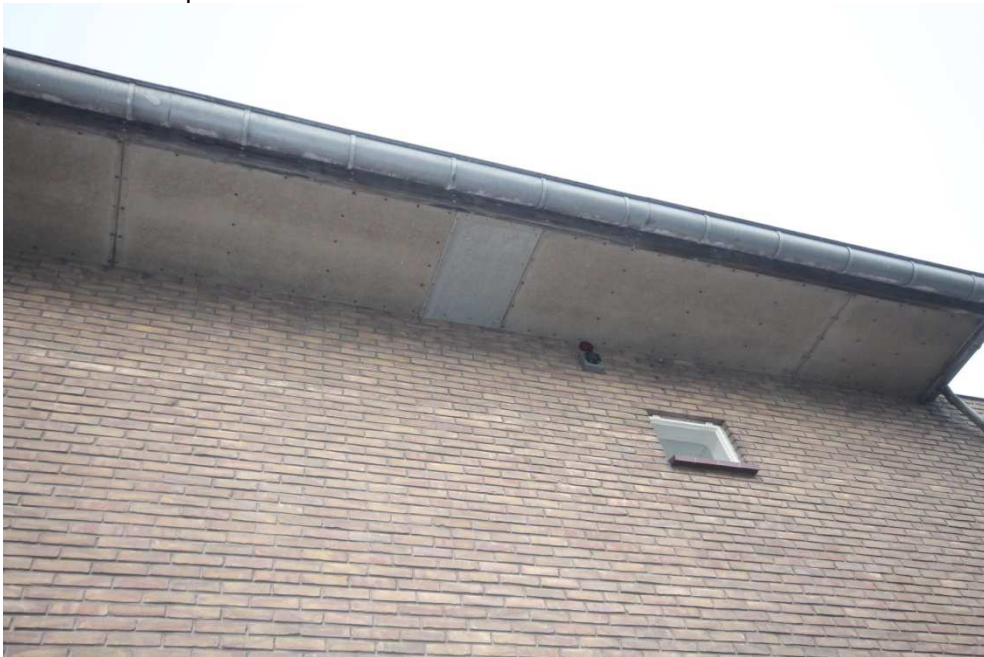
Asbest in de kap
