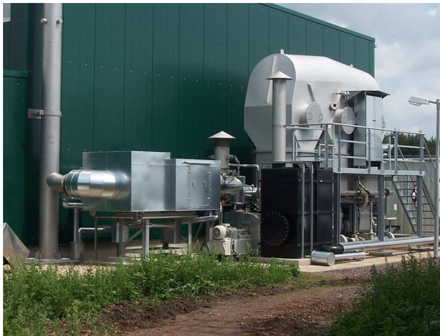
Afbeelding 21: RTO-installatie van een vergelijkbare installatie
