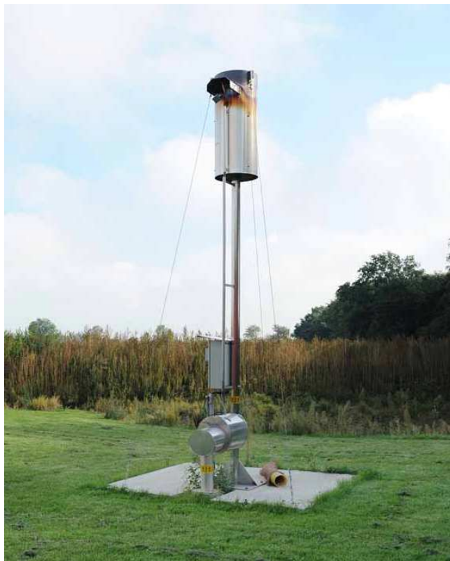
Afbeelding 1: Noodfakkel (A5401) geïnstalleerd in een vergelijkbare Biogasininstallatie
